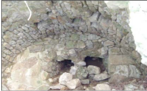
Photo 25 - Arrivées d'eau au fond du moulin de la Vallée Obscure.
