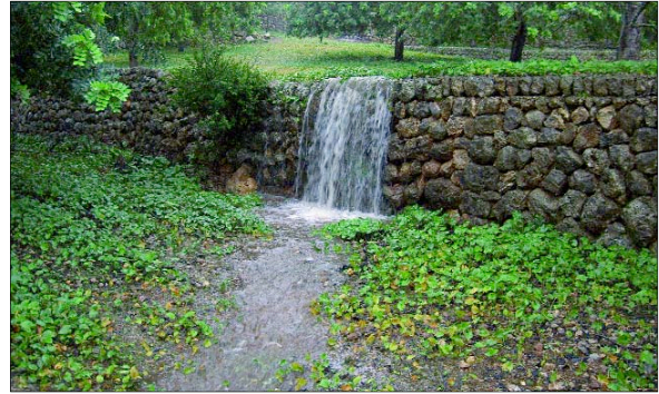
Fotografia 20 - Escolament lliure de l'aigua per manca d'estructura de drenatge.
