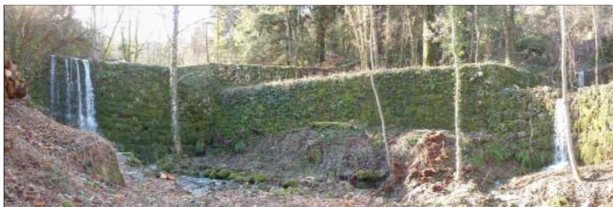
Photo 22 - Système de tancats sur le Valescure (à gauche – 6,5 m de haut) et sur un valat affluent à proximité de la Jasse.
