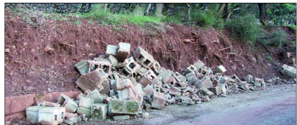
Fotografia 23 - Caiguda d'un mur de sosteniment de nova construcció, resultat de la utilització de materials i tècniques inadequades.
