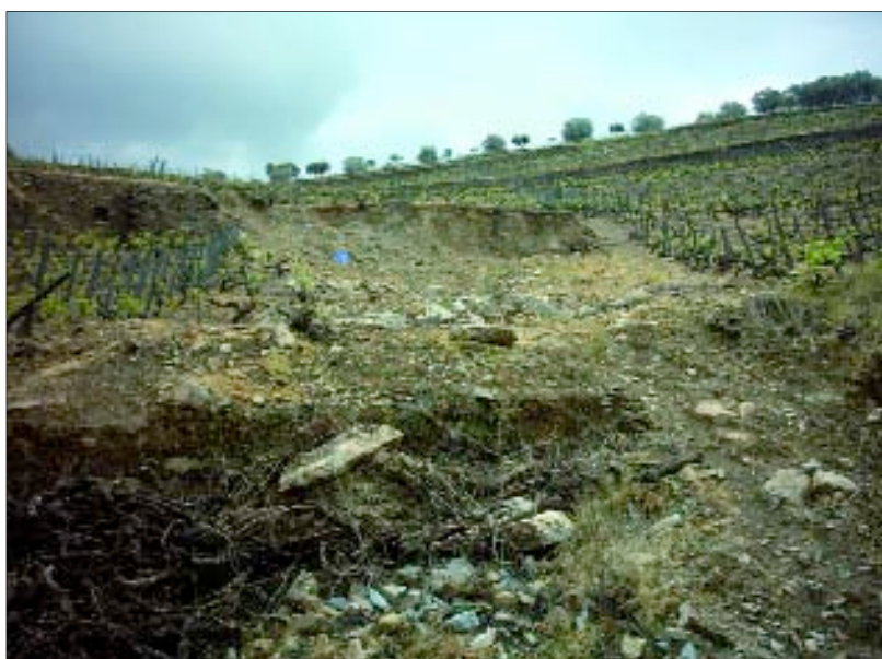
Fotografia 7 - Muro de pedra em seco destruído.
