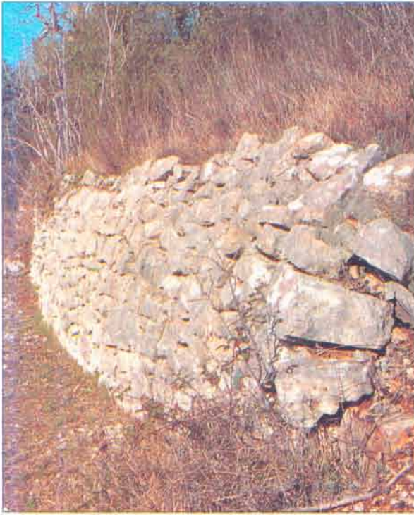
8. Marge en mal estat de conservació: fase inicial d'un bombament (Saint-Cézaire-sur-Siagne, le Colombier, àrea B).
