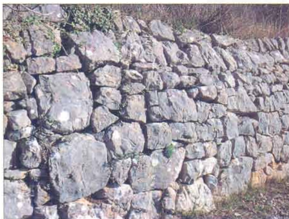
278. Un bombement localisé menace un mur à l'appareillage pourtant travaillé (Saint-Cézaire-sur-Siagne, Le Serre, aire B).
